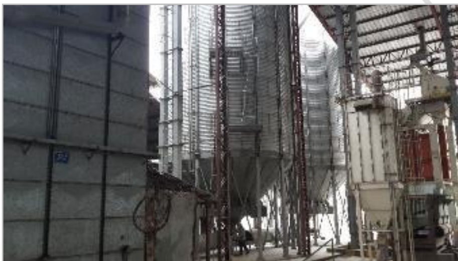
INDUSTRIA ARROCERA – ECUARROCERA SISTEMA DE RECEPCION, LIMPIEZA Y SECAJE
